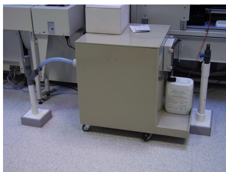
Automate équipé du traitement des effluents
